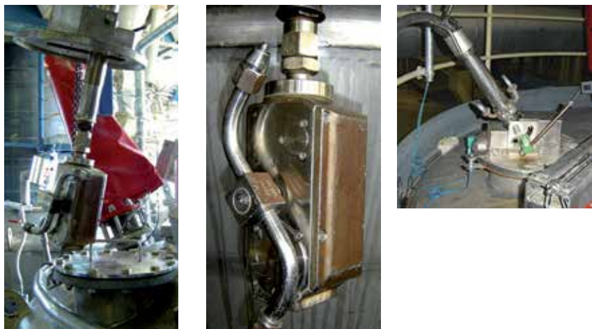
图6：安装在空余的法兰上的反应釜或储罐的移动喷头，连接高压供水，喷头围绕管轴水平和垂直旋转。
